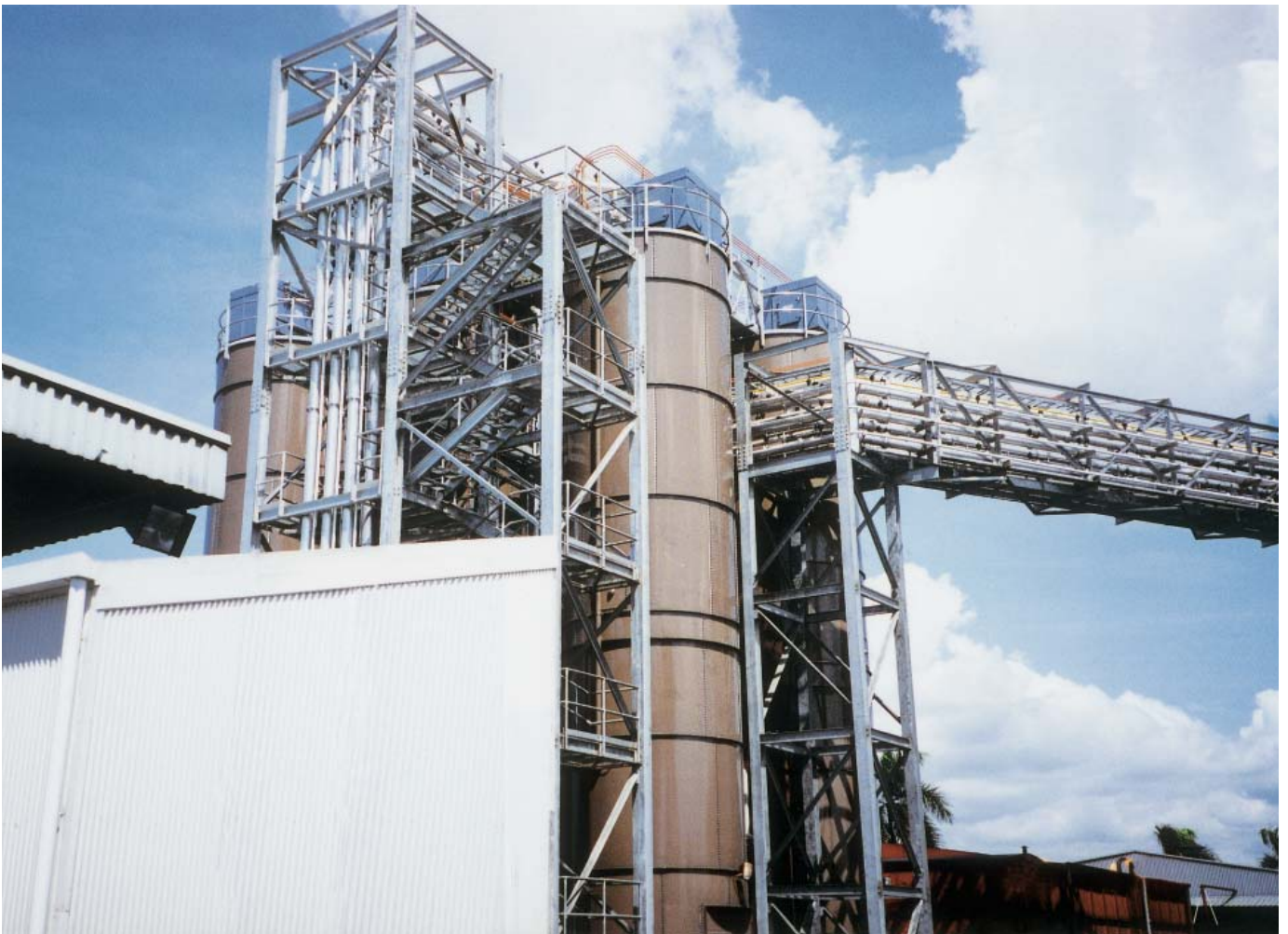
Una instalación completa para el transporte de negro de humo.
