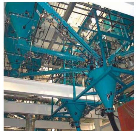
Deslizadores neumáticos de alta precisión Dyna-Slide™ transportan un producto desde un depósito de 6 m³ hasta diversas tolvas pesadoras.
