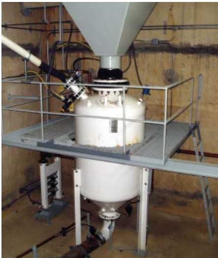
Sistema de transporte neumático en fase densa
