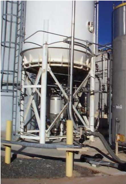
Sistemas de descarga de silo y transporte
