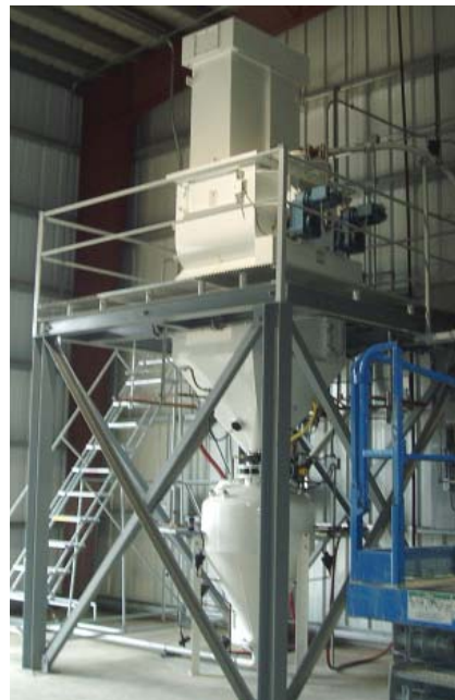
Sistemas de mezcla y transporte
