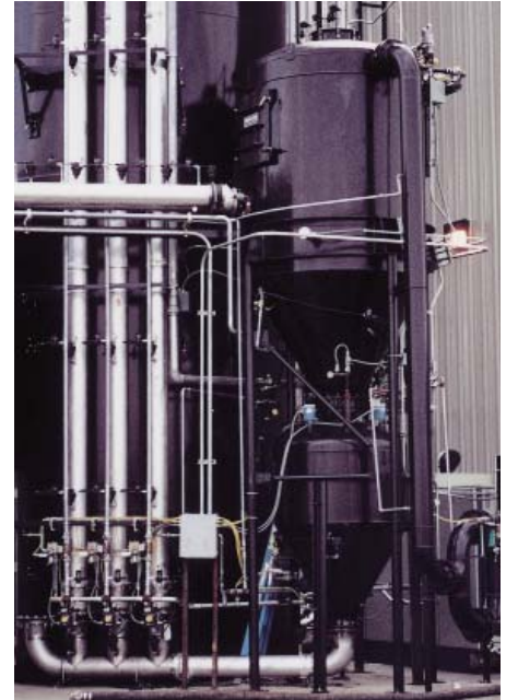
Sistema de transporte del negro de humo a alta densidad en vacío
