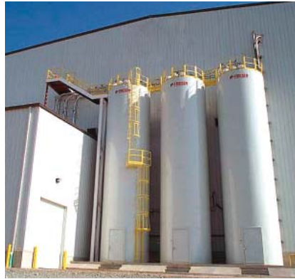
Transporte neumático a silos por el Concepto de Línea Llena™
