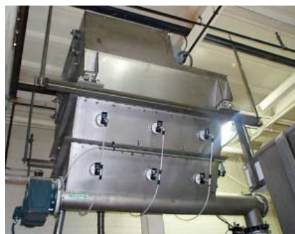
Sistemas de almacenamiento y dosificación.
