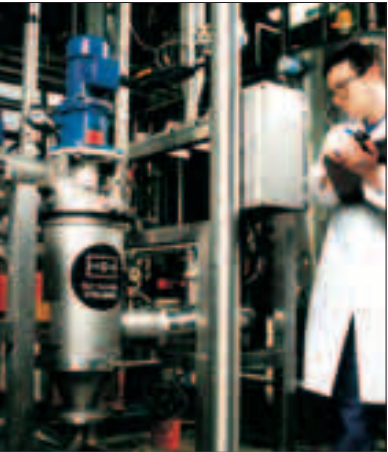
Filtro Autolimpiante Russell Eco Filter® instalado en etapa de prefiltración en la fábrica de sidra H.P. Bulmer
